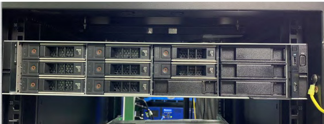
รูปที่ 2-199 ภาพอุปกรณ์เครื่องแม่ข่ายหลังดำเนินการติดตั้ง
